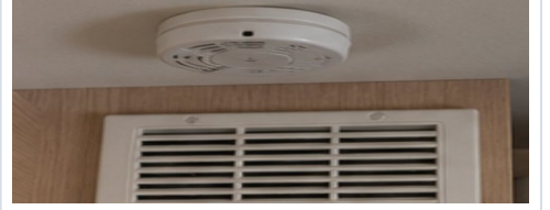
F06 - CO/duman alarmı ve havalandırma menfezleri
