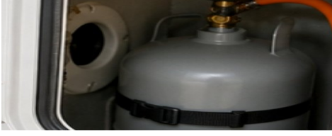
F01 - Gaz dolabı havalandırması ve tüp sabitleme
