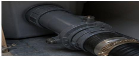
H02 - Atık su deposu, vana ve tahliye hattı
