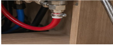
H05 - Kazan/boiler kaçak ve emniyet tahliye kontrolü
