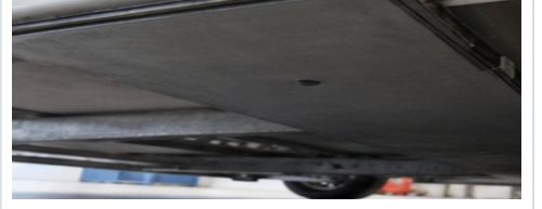
D07 - Alt izolasyon, taban koruma ve korozyon izi
